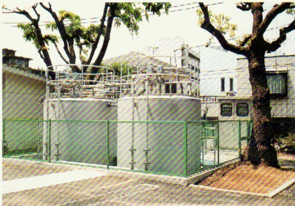
慶應義塾大学医学部 R I 排水設備
